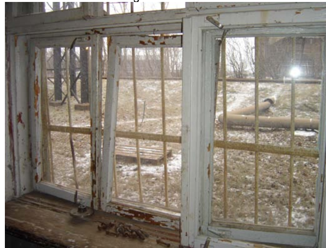
2.attēls. Bojāti logi.
